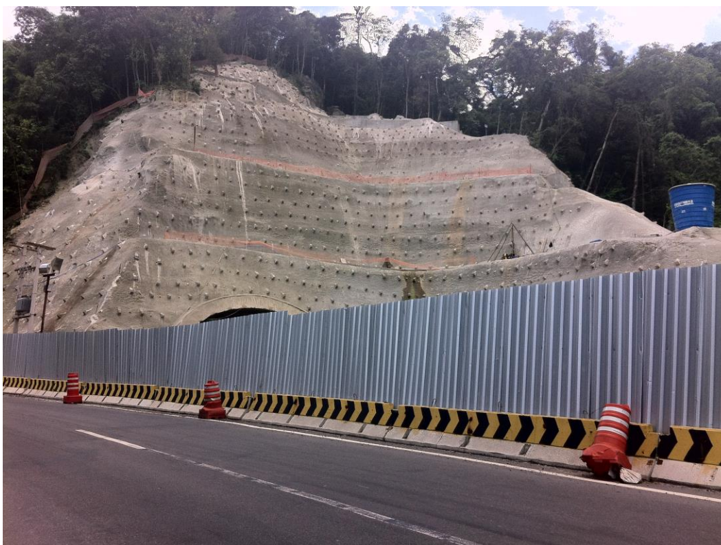
Figura 4 – Nova subida da Serra de Petrópolis ( arquivo pessoal – 2015 ) – Emboque do túnel escavado e ao lado, talude natural.
