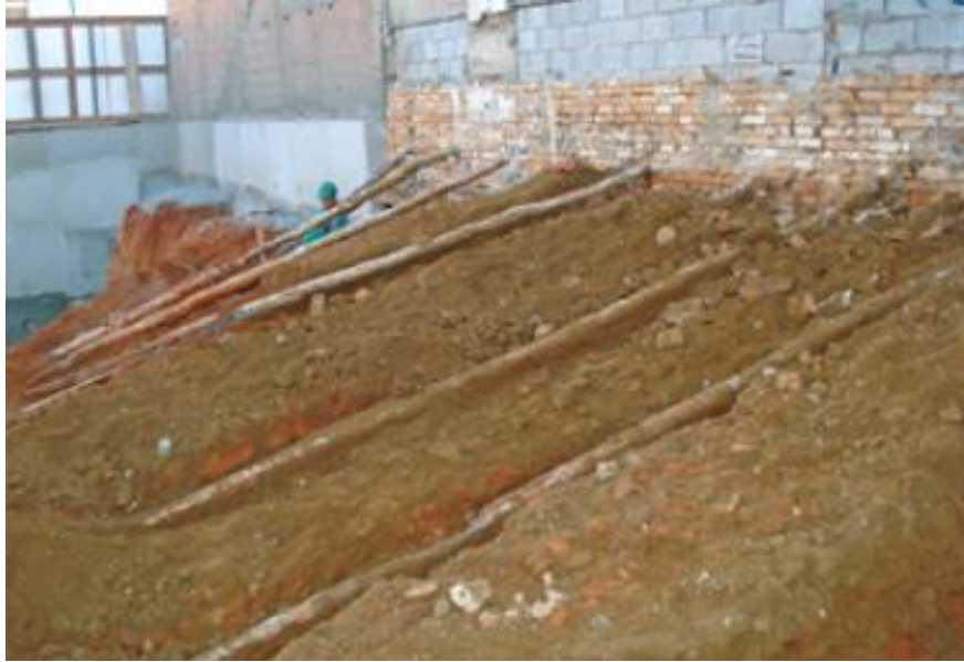
Figura 34 – Detalhes da escavação dos grampos da construção do Ed. Astor (Souza et al, 2007)
