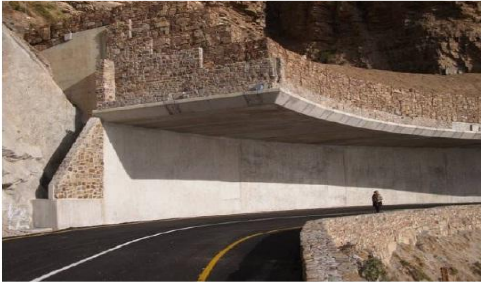
Figura 14 – Túnel falso para proteção em uma estrada na África do Sul (Volkwein et al., 2005).
