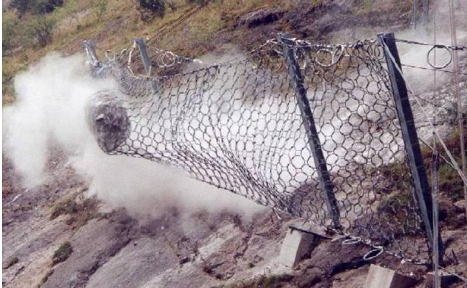
Figura 18 – Barreira Flexível instalada em encosta rochosa em uma estrada na África do Sul (Volkwein et al., 2005)
