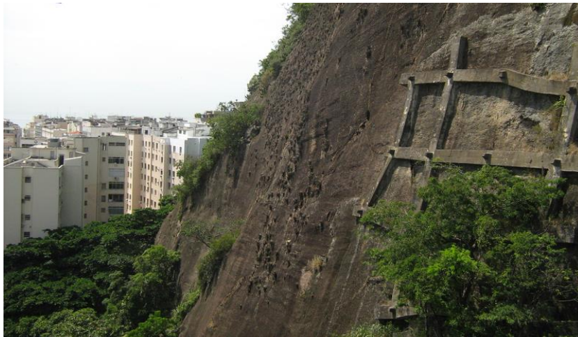
Figura 31 – Grelha atirantada na escarpa da Rua Prof. Gastão Bahiana (GEO-RIO, 2009)
