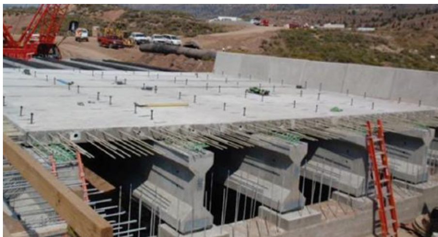
Figura 4- Tabuleiro de ponte em Emma Park Bridge com barras de GFRP. (ACI 440.1R-15)
