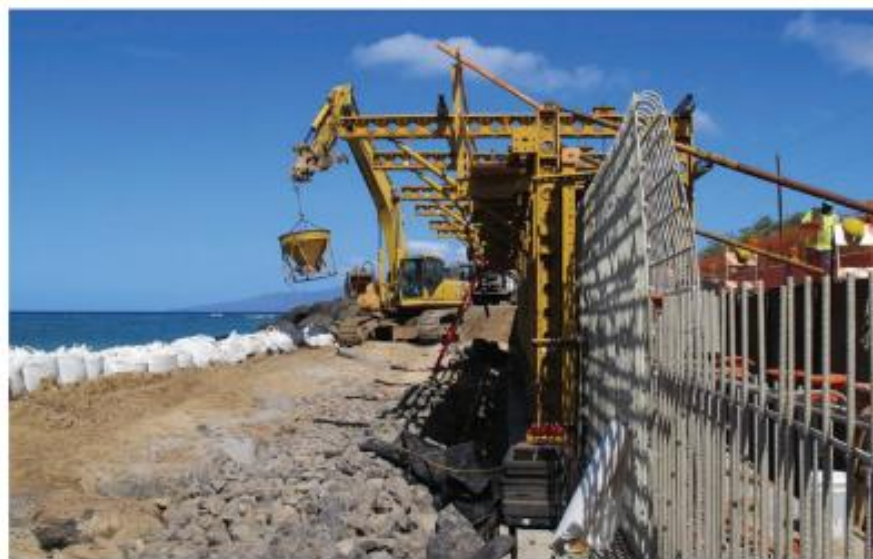
Figura 3- Substituição de barra de aço por GFRP no paredão que protege a rodovia Honoapiilani, em Maui, HI. (ACI 440.1R-15)
