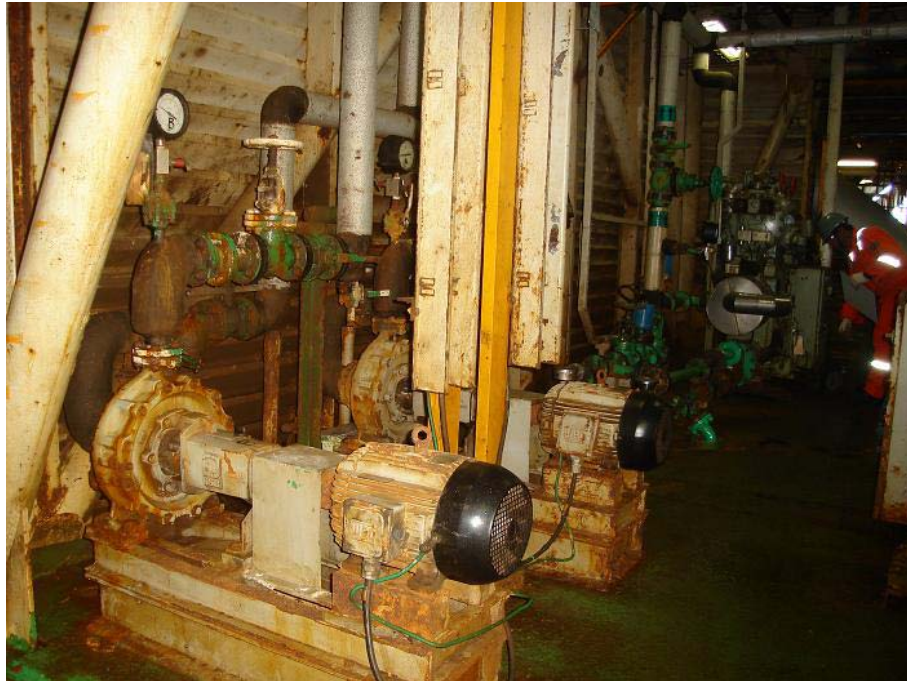
Figura 3 – Bomba de água gelada
