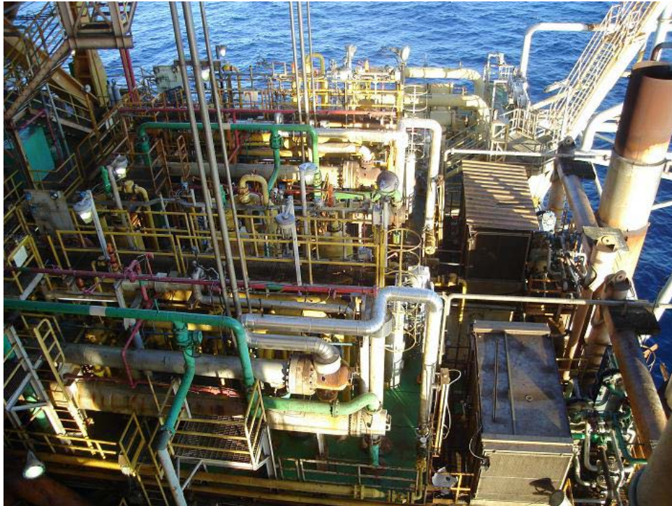
Figura 2 – Vista superior do turbo-compressor
